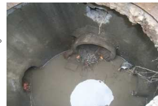
雨水配管が破壊しており、木根が侵入し、流れを阻害していた部分
