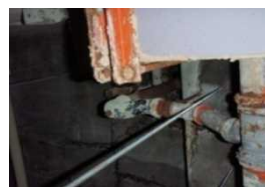
腐食・発錆が著しい配管類
