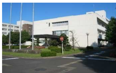
④. 管理棟(1981) 耐震性は確保されているが、築43年を経過し、老朽化が進んでいる。また、バリアフリー対応になっていない。
