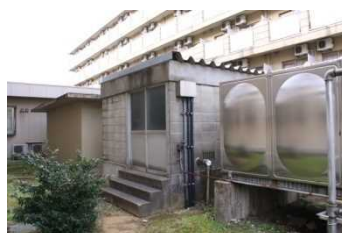
⑤. ポンプ室(1975.2000)
