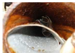
内面ライニングが剥離し、脱落した状況
