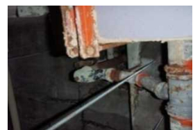
腐食・発錆が著しい配管類
