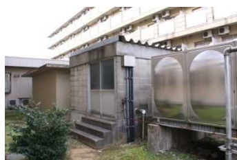
⑤. ポンプ室(1975.2000)
