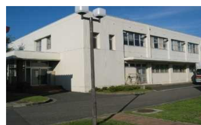
⑧. 福利施設(1983) 築42年を経過し、老朽化が進んでいる。
