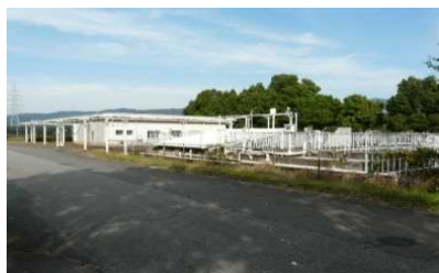
③. 排水処理機械室(1980) 築45年を経過し、老朽化が進む。
