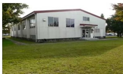
⑨. 武道場(1984) 築41年を経過し、老朽化が進んでいる。 2011年に便所等のアメニティスペースの改修を行った。
