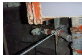
腐食・発錆が著しい配管類
