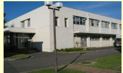
⑧. 福利施設(1983) 築39年を経過し、老朽化が進んでいる。
