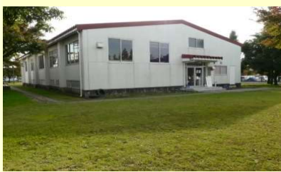
⑨. 武道場(1984) 築38年を経過し、老朽化が進んでいる。2011年に便所等のアメニティスペースの改修を行った。
