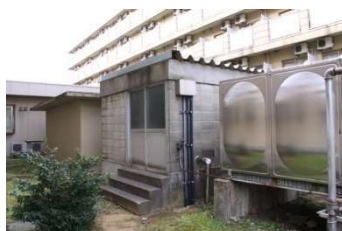
⑤. ポンプ室(1975.2000)
