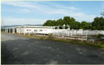
③. 排水処理機械室(1980) 築42年を経過し、老朽化が進む。
