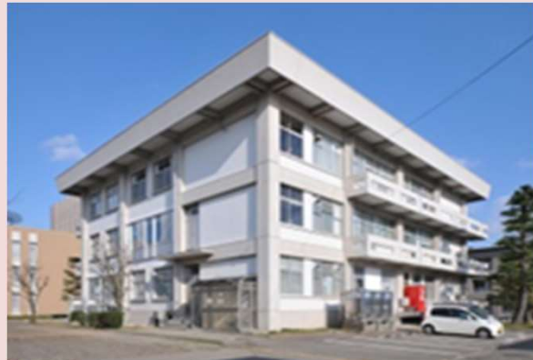
②. 本部棟(1967,1988, 2016耐震改修) 築55年を経過し、老朽化が進んでいる。2016年に耐震改修のみ完了したが、機能が悪い。また、来客が多く、スロープや自動扉の設置等出入口のバリアフリーを行ったが、内部はバリアフリーに対応していない。
