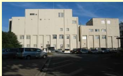
⑥. RI施設 (1982, 1994) 築40年を経過し、施設・設備等の老朽化が著しい。生物資源部門は2022年度に改修を完了しており、引き続きRI部門のアイソトープ施設の整備方針の決定が必要である。
