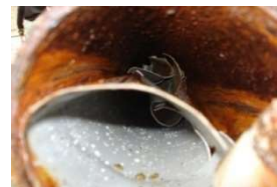
内面ライニングが剥離し、脱落した状況
