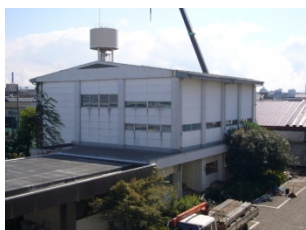
第 2 体育館(武道場): 築 40 年で老朽化が進んでいるので改修を計画する。
