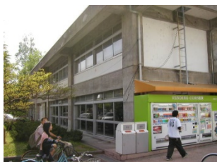
大学会館：築 47 年を経過し老朽化が著しく耐震性も悪い
