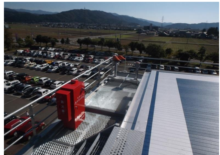
移動式消火設備・粉末ABC消火器
