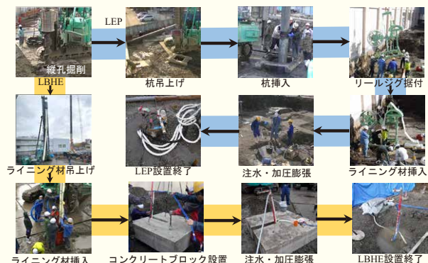
図 2 工学部百周年記念施設における LBHE および LEP の施工の様子
