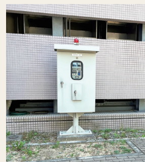
排水モニター槽
