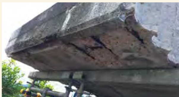
写真2 劣化した道路橋コンクリート床版
