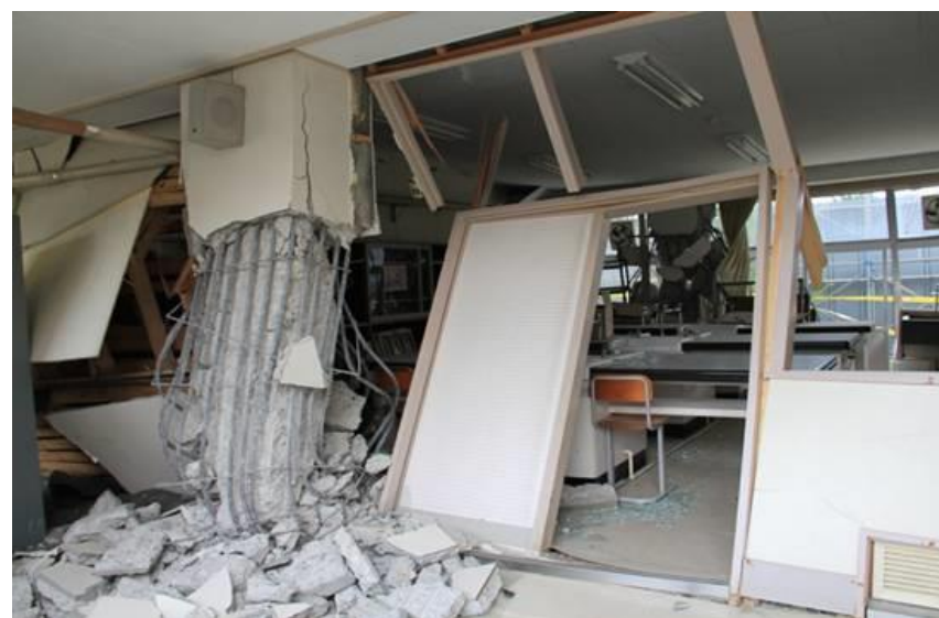
旧耐震基準で建築された学校施設(福島県本宮市立本宮第二中学校) (「東日本大震災の被害を踏まえた学校施設の整備について」緊急提言より)
